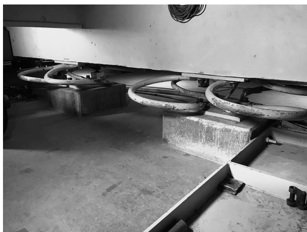
写真3 ループ状鋼棒ダンパ
