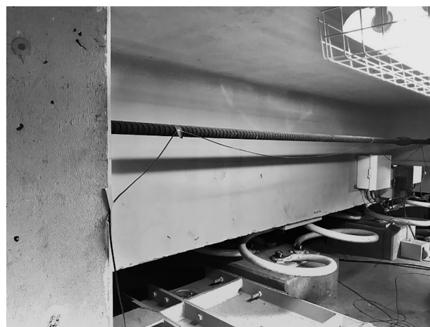
写真5 免震層に設置されたPC鋼棒
