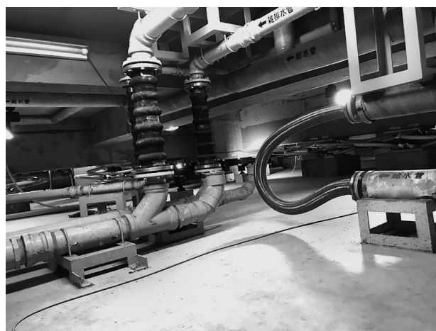
写真4 設備配管継手
