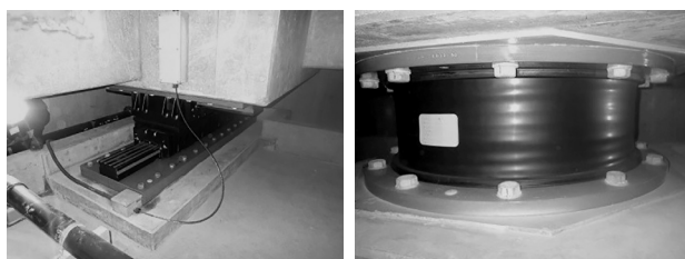
写真9 基礎部 免震装置
