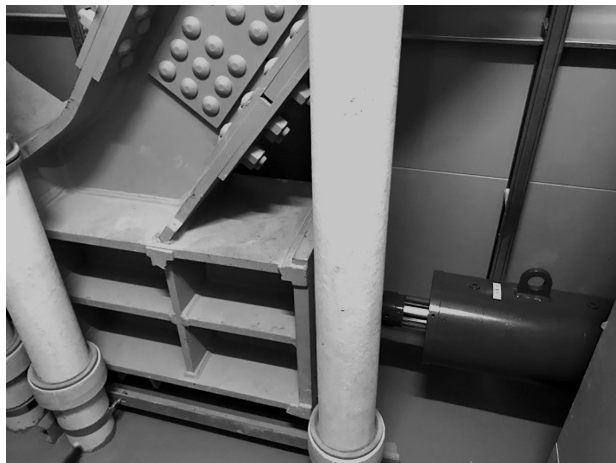
写真7 制震ブレース
