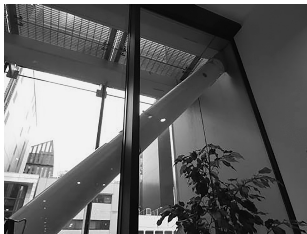
写真4 店舗側からみたオイルダンパー
