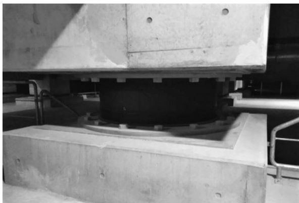
写真11 免震層の見学（鉛プラグ入り積層ゴム）
