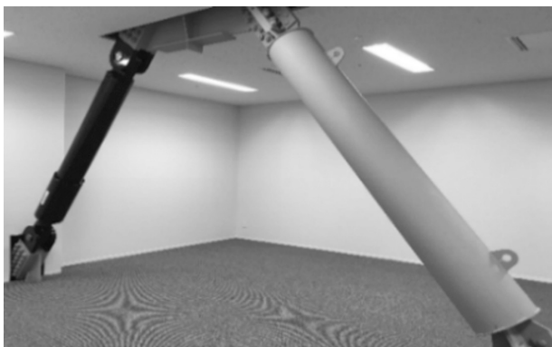
図2-4 ダンパー設置状況
