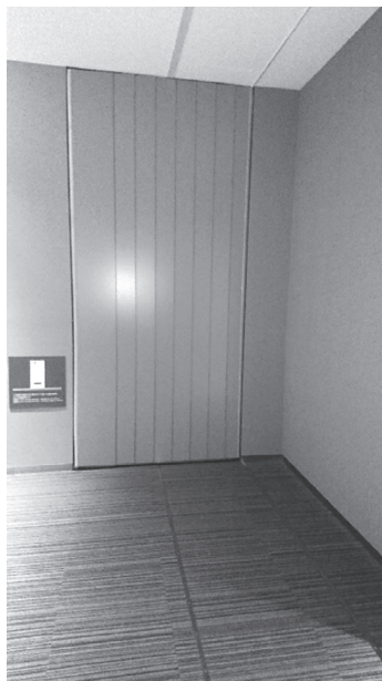
写真13 南館 (左側) と本館 (右側) をつなぐ廊下の壁床の免震エクスパンションジョイント
