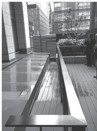
写真15 本館 (左側) と南館 (右側) をつなぐ床の免震エクスパンションジョイント
