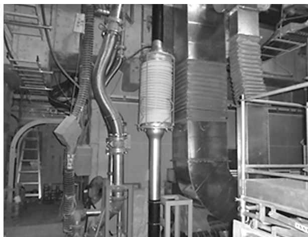
写真13 設備メインシャフト内の配管・ダクト類 （大地震時の躯体の変形量に対応する免震継手を設置）
