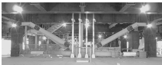
写真4 オイルダンパー（オフィス階）
