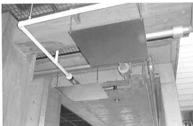
写真-9 天井に設置された設備配管
