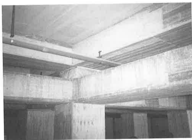
写真-2-2 1階柱頭部の柱梁交差部上に設置された積層ゴム
