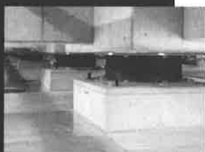
免震装置設置状況 LRB (φ1200)
