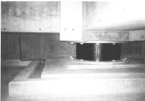
写真一 地震後の免震装置
