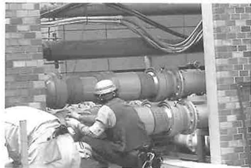
写真一九 免震対応設備配管
