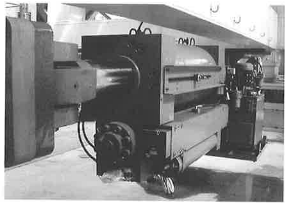
図-12 多機能ダンパーの取付状況
