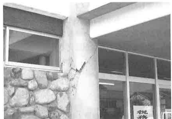
写真2 遠野市市役所正面玄関のせん断破壊 (清水建設(株)和泉研究室提供)
