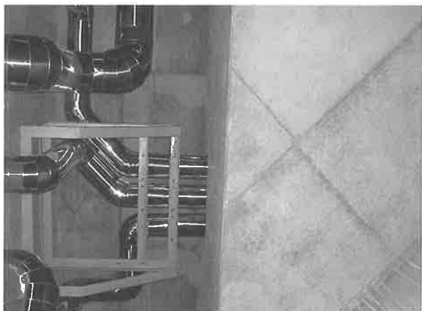
写真-5 配管の様子（上向き）
