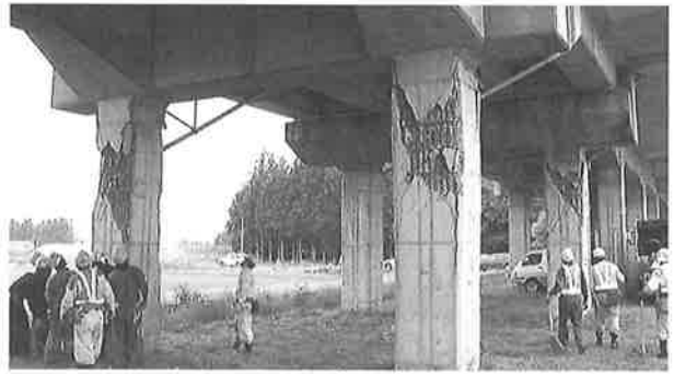
写真6 東北新幹線の高架橋のせん断亀裂 (岩手県石鳥谷町、(株)ダイヤコンサルタント提供)
