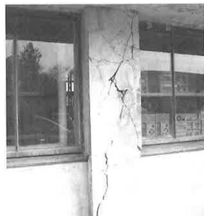
写真3 旧千厩中学校の柱のせん断亀裂 (東北工業大学舟木尚己博士提供)
