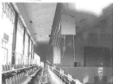
写真5 室根村の体育館での天井材の落下 (清水建設(株)和泉研究室提供)
