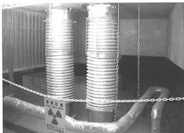
写真-11 免震層を通過するダクト
