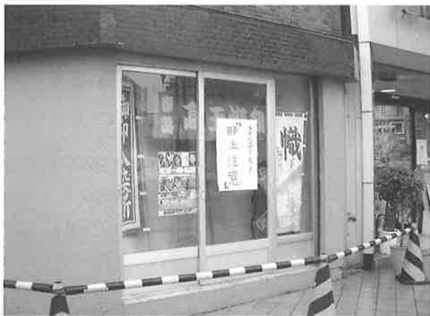
写真-6 外壁にクラックが生じた建物
