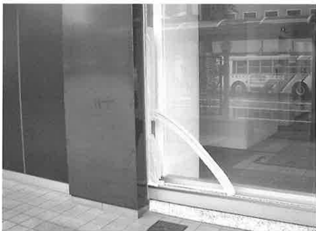
写真-7 ショーウィンドウのガラス破損
