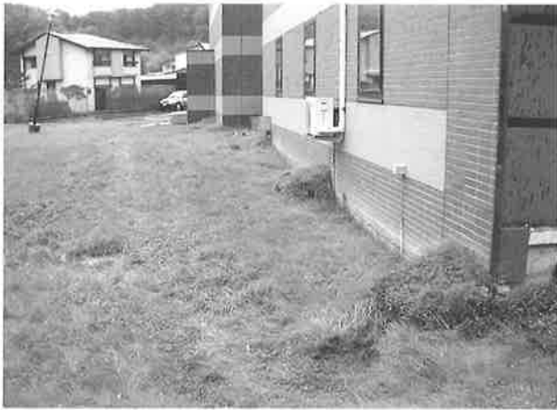
写真一12 杭基礎建物周囲の地盤沈下
