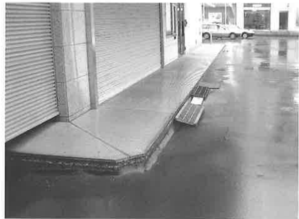
写真一14 免震建物周囲の地盤沈下
