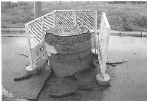
写真-11 釧路市内におけるマンホールの突出
