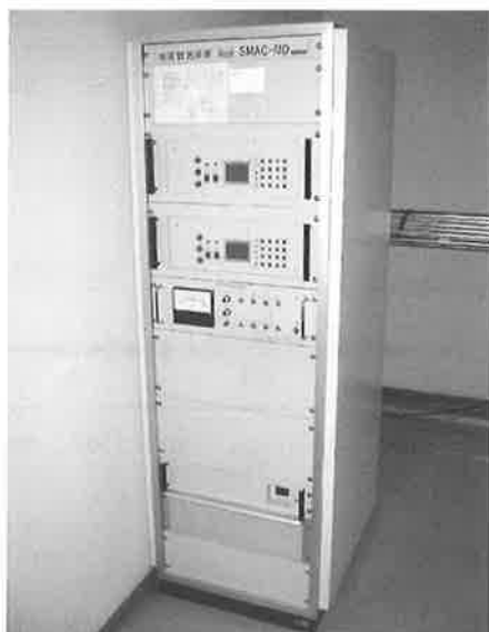
写真-1 地震データ収録装置（制御室内）
