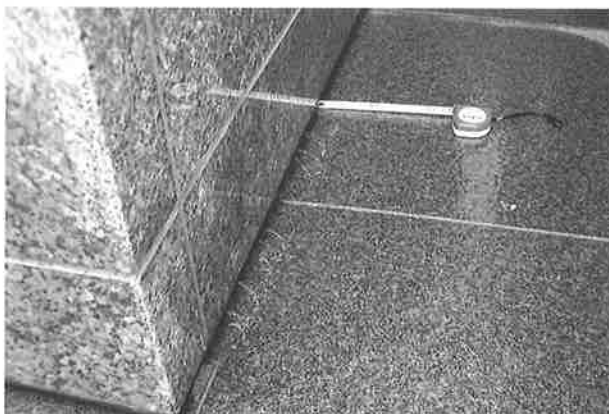
写真-9 免震建物が移動したと思われる軌跡
