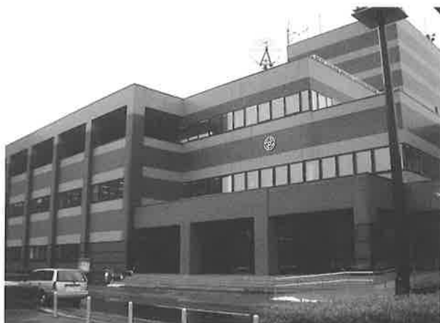
(b) 地震発生の2日後の復旧状況 写真一13 地盤の不同沈下により庇が倒壊した建物
