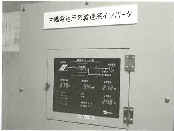
写真-8 太陽光発電状況
