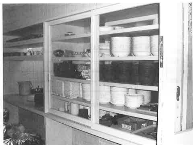
1階厨房食器棚：食器などが落ちることはなかった。
