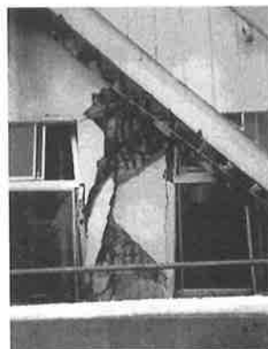
写真3 本館病院被害部分
