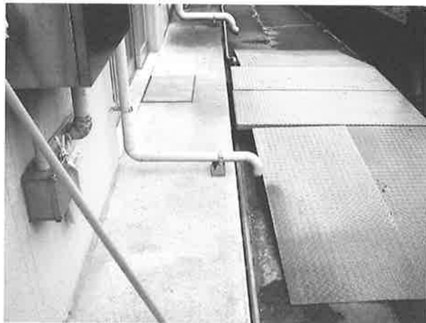
台車などの搬入口：建物に押されて移動。復旧は容易である。
