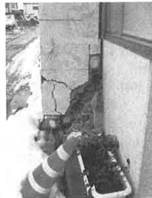
写真4 商店街被害部分
