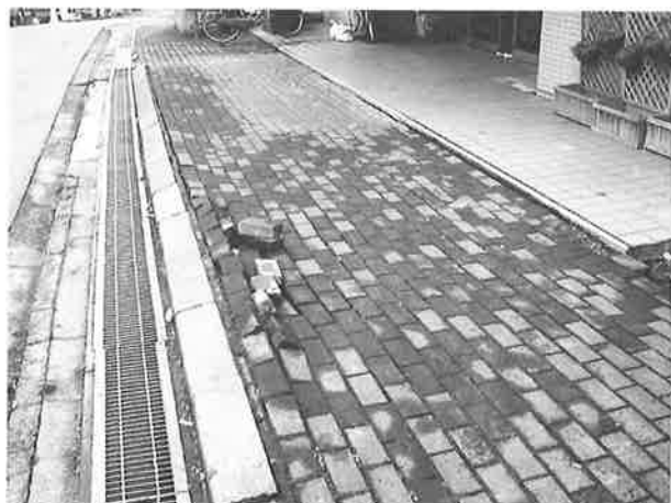
エントランス： 車いす対応のため、段差なしで設計。砂締めインターロッキングが建物に押されて浮き上がった。
