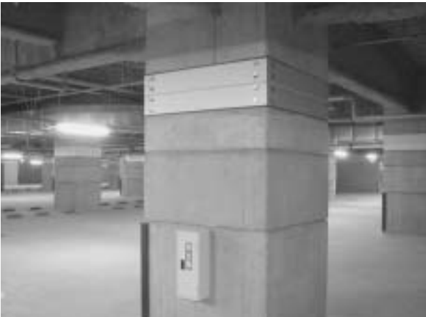
写真10 免震装置(柱頭免震、耐火被覆)
