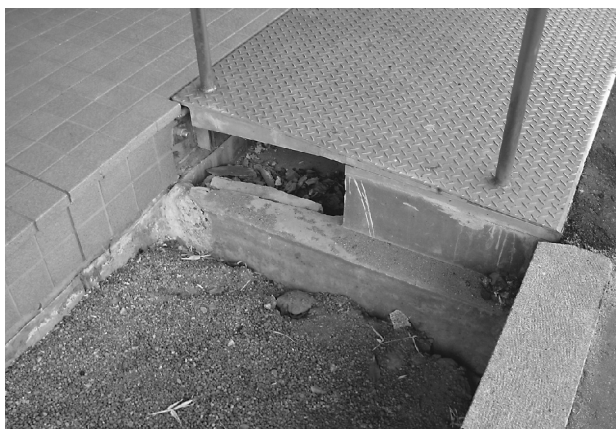
写真5 破損したエキスパンション部
