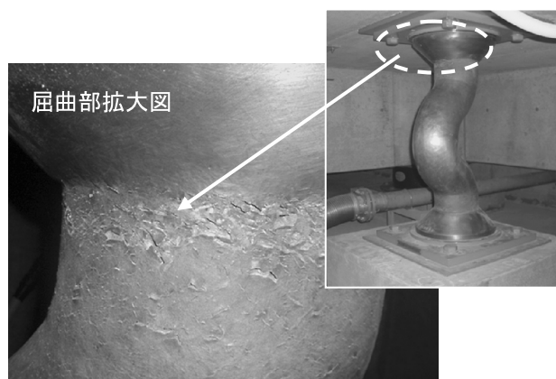
写真7 鉛ダンパー変状 (F建築物)
