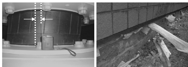
写真4 積層ゴム残留変位及び縁切り用シート変状 (B建築物)
