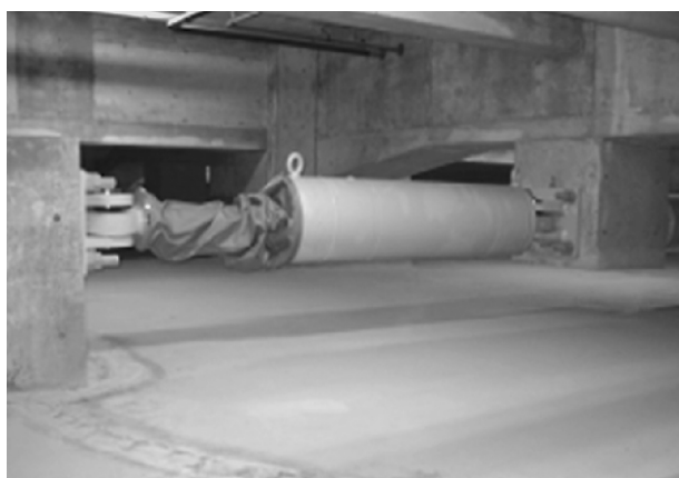
写真3 オイルダンパー
