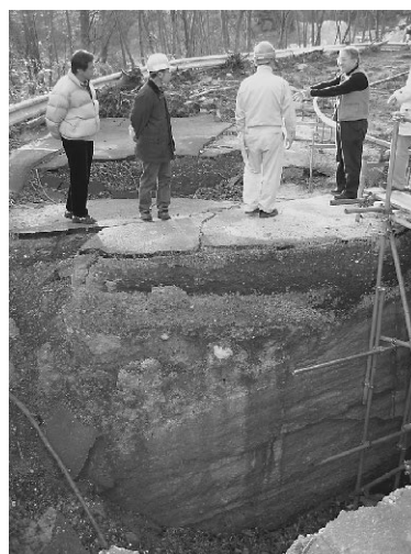
写真6 説明を受ける一行と、荒砥沢ダム周辺道路の被害状況
