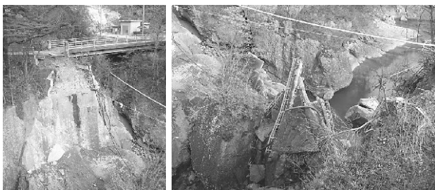
写真11 矢櫃ダムにかかる旧道橋の倒壊
