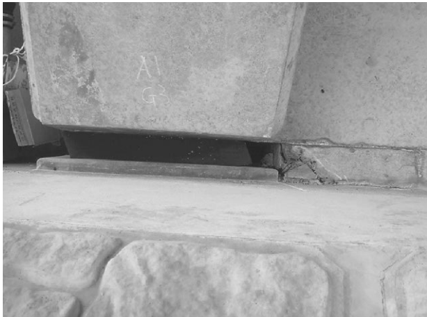
写真15 榎木平橋の免震支承
