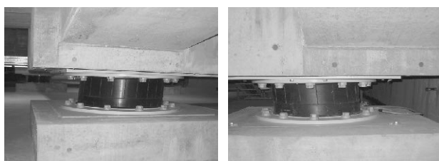
写真2 免震装置の傾斜 (左：図2の①点 右：同②点)
