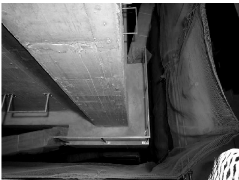
写真4 オイルダンパー取付部
