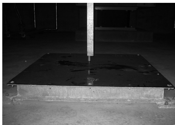
変位記録装置
