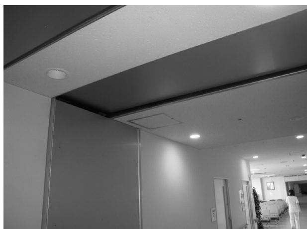
写真8 免震エキスパンション部（天井）の損傷
