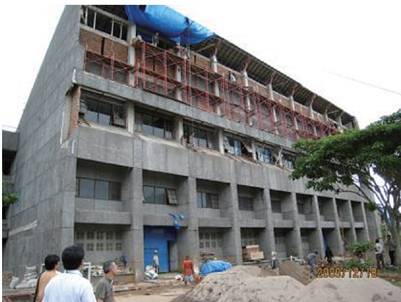
写真5 アンダラス大学のレンガ外壁の被害
