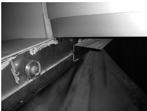
写真7 免震エキスパンション部（床）の損傷
