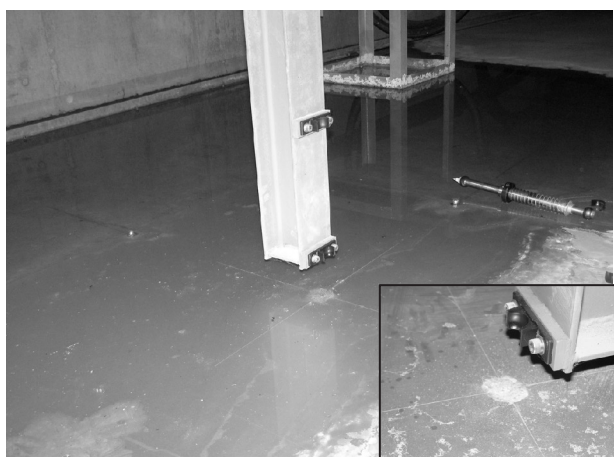
写真2 病院（B棟）の罫書型地震計の損傷状態
