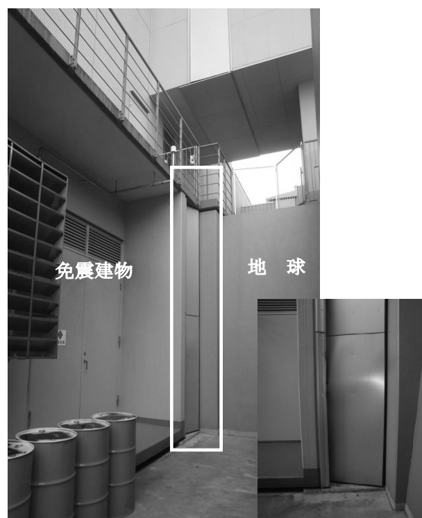
写真6 免震カバープレートの損傷
