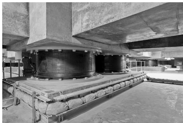
図6 コアウォール下部の免震装置
