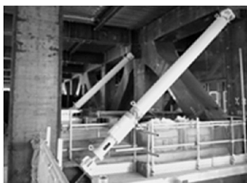
写真4 オイルダンパー
