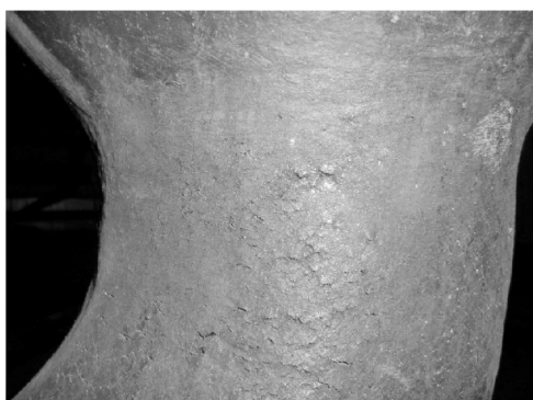
写真2.4 関東の建物で確認（深さ：約3mm）
