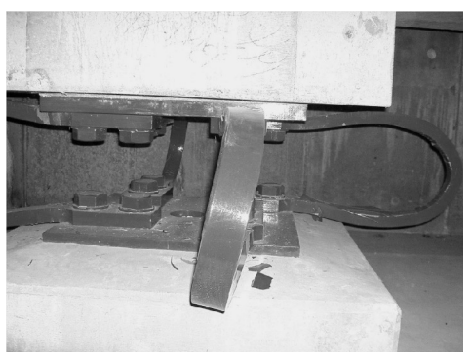
写真2.1 ダンパーロッドの残留変形
