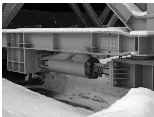
写真4 アリーナ棟水平ダンパー
