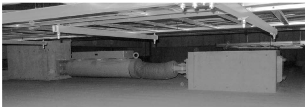
写真7 オイルダンパー
