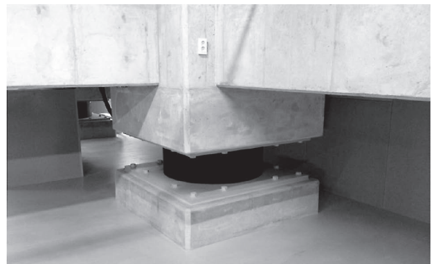
写真10 積層ゴムアイソレータの配置状況
