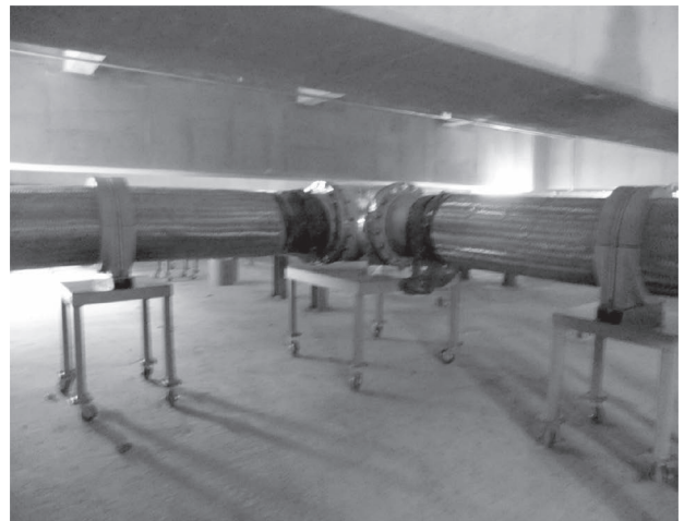
写真9 韓国製の可撓継手の配置状況
