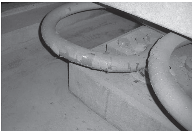
写真2 スチールダンパーSDの状況
