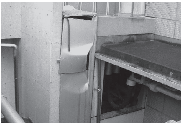
写真3 エキスパンション金物の変形
