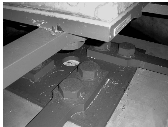
写真9 スチールダンパーSD取付部の状況
