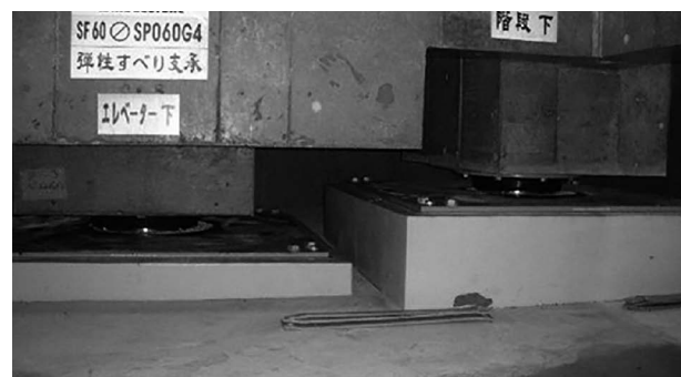
写真10 弾性すべり支承の状況
