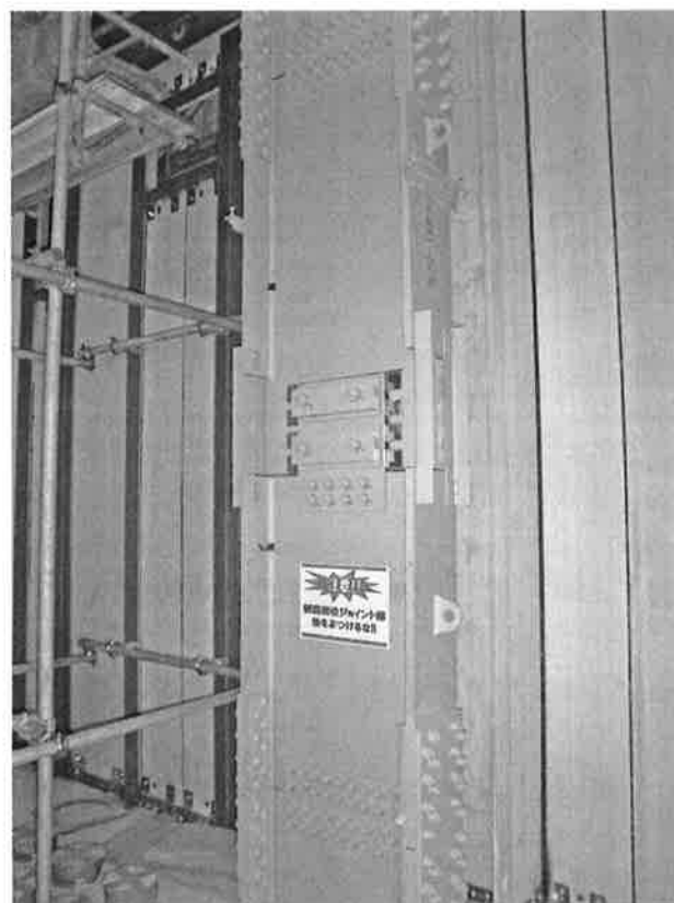
写真2 摩擦ダンパー設置状況
