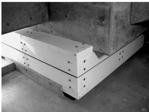
写真10 免震装置（直動転がり支承）
