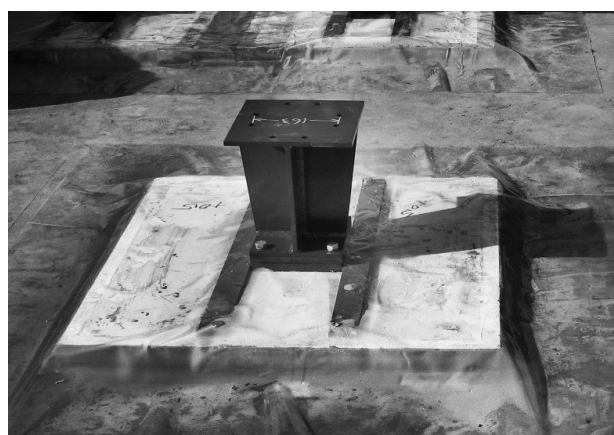
写真2 すべり支承（上部鉄骨束材）
