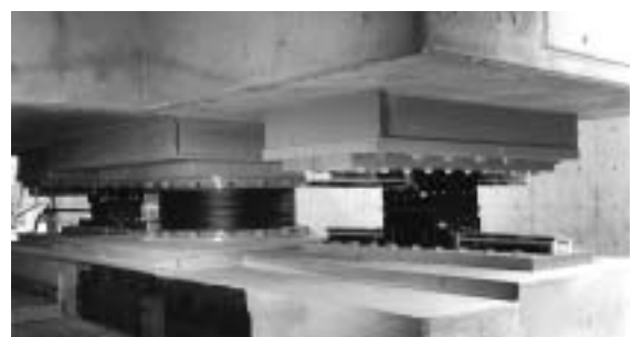
柱直下に設けた積層ゴムと補強梁先端に設けた転がり支承 (撮影：三島 寛)
