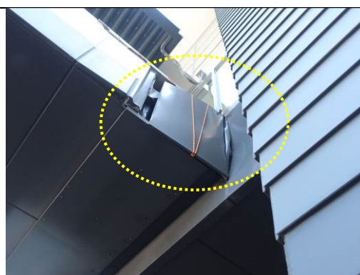
図 4.9-4 渡り廊下の Exp.J パネルのずれ
