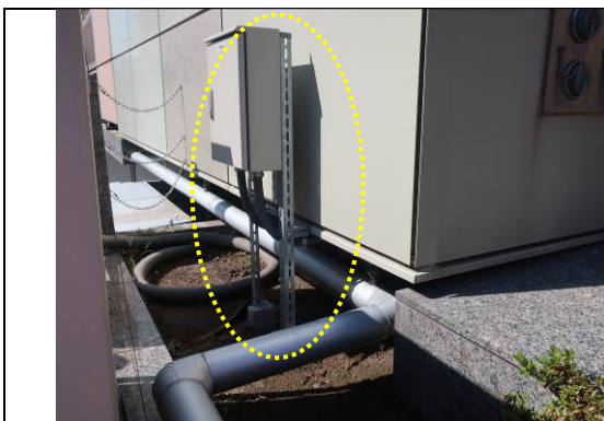
図 4.8-7 外構設備機器のずれ 1
