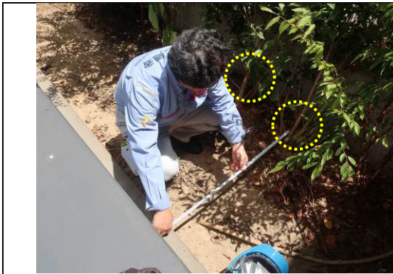
図 4.1-5 犬走りと植栽との接触（東方向）
