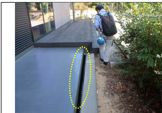
図 4.1-7 犬走りの残留変位による隙間
