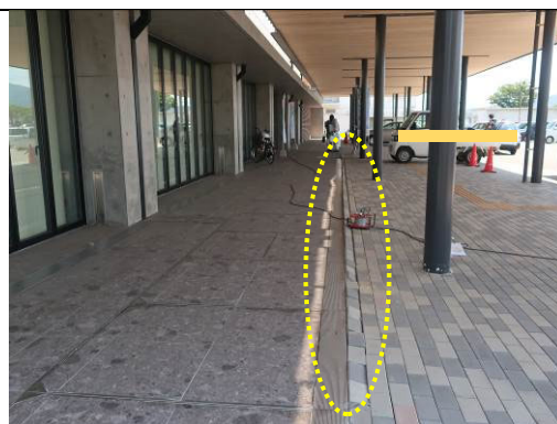
図 4.5-2 免震 Exp.J パネルのずれ
