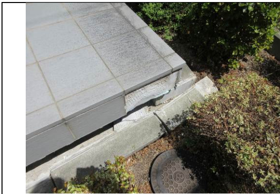
図 4.14-4 犬走りの損傷および外構のずれ
