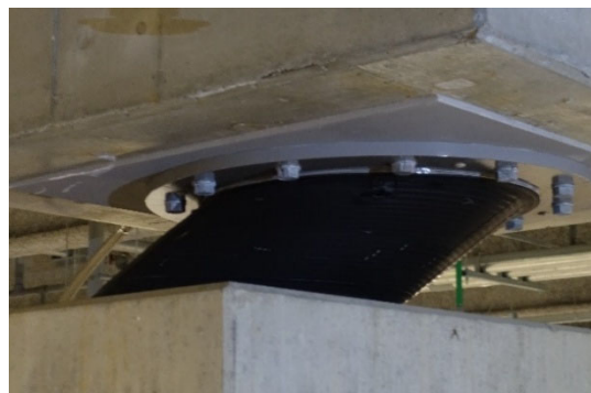
図 4.1-23 積層ゴム支承の残留変形
