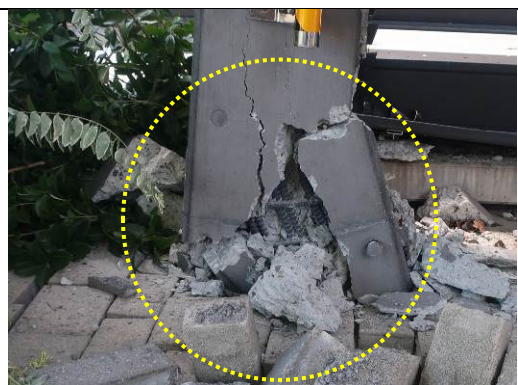
図 4.1-16 キャノピー柱の脚部の損傷
