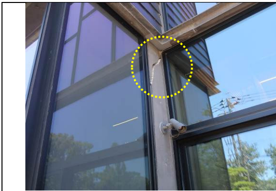
図 4.1-11 コンクリート外装パネルの損傷
