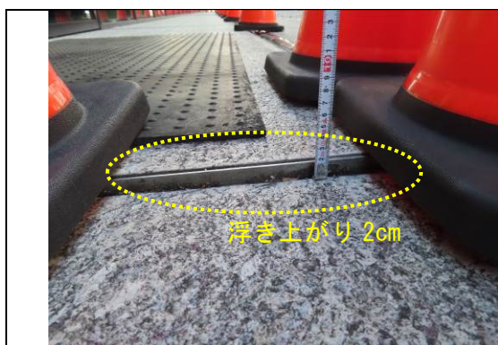
図 4.12-3 Exp.J パネルの浮き上がり
