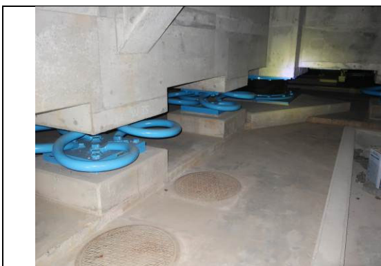
図 4.8-9 免震部材の様子
