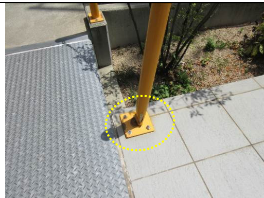
図 4.14-7 Exp.J パネル付近のポールの損傷
