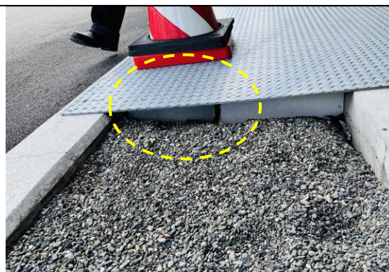
図 4.19-4 Exp.J 下の砂利止めパネルの損傷
