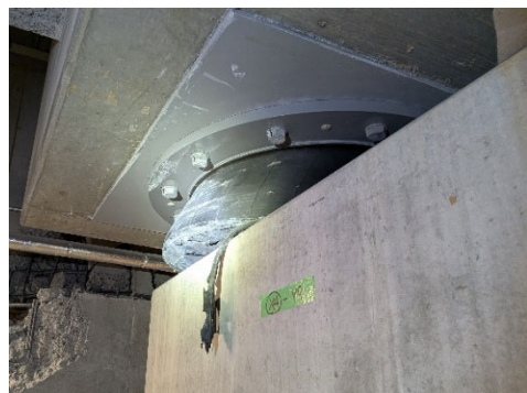
図 4.1-22 積層ゴム支承材の損傷
