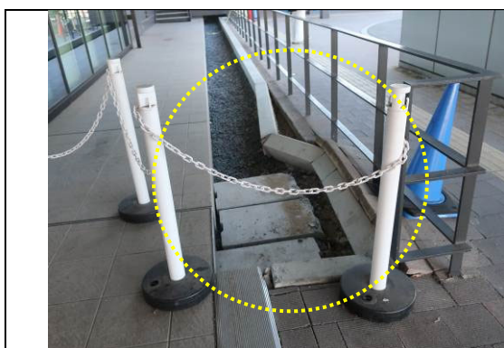
図 4.9-3 正面玄関付近の損傷
