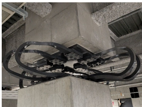
図 4.1-24 U 型鋼材ダンパーの残留変形 1
