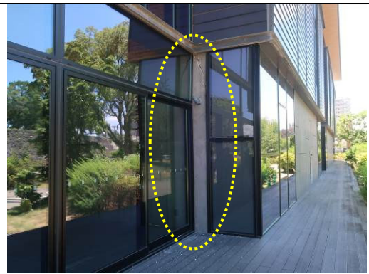
図 4.1-12 ガラス枠材の変形
