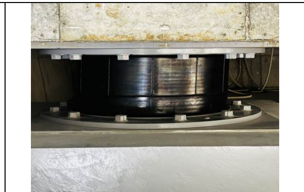
図 4.19-7 積層ゴムの残留変位の様子
