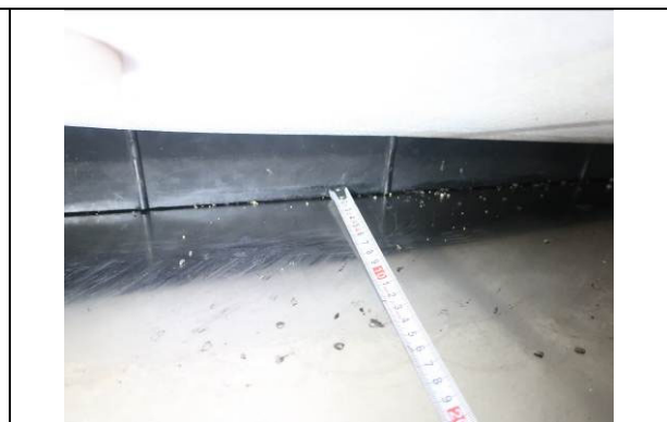
図 4.9-7 弾性すべり支承の摺動跡
