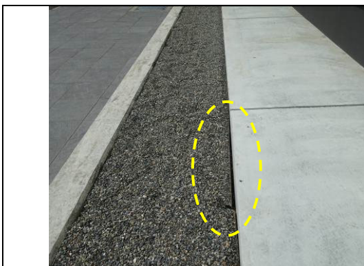
図 4.19-3 南東側の緩衝材の変形
