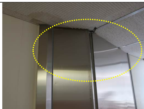
図 4.8-4 連絡棟の Exp.J パネルのずれ 2
