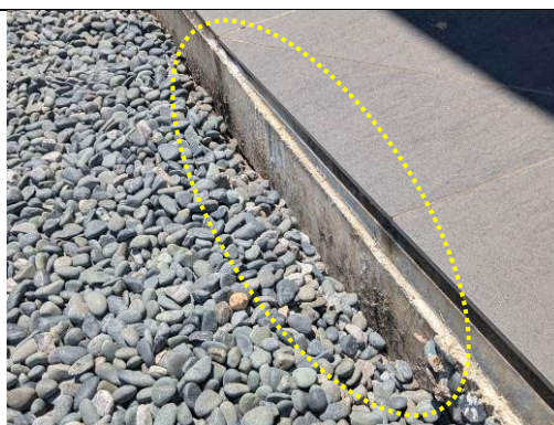
図 4.6-4 砂利が押し出された形跡
