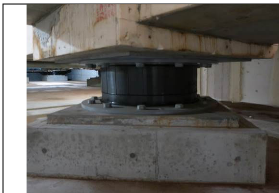
図 4.18-3 積層ゴムの様子
