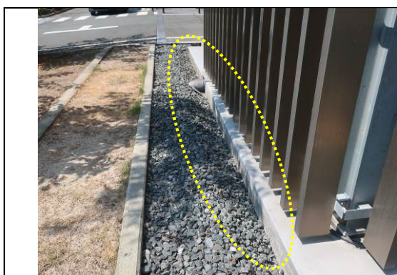
図 4.11-3 砂利が押し出された形跡
