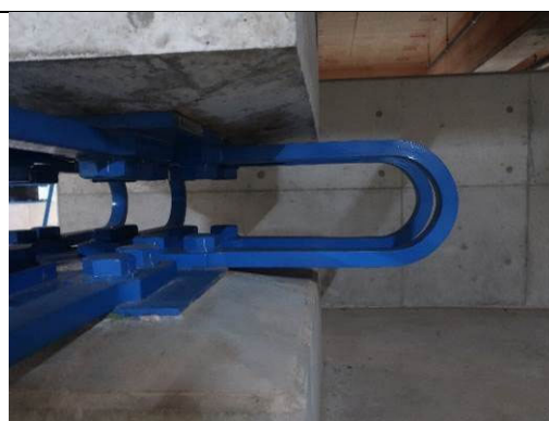
図 4.15-4 鋼材ダンパーの様子
