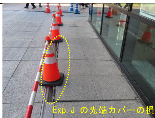
図 4.12-4 Exp.J の先端カバーの損傷 1
