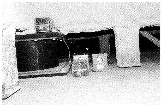
地下1階の床下の免震装置と地震の記録計
