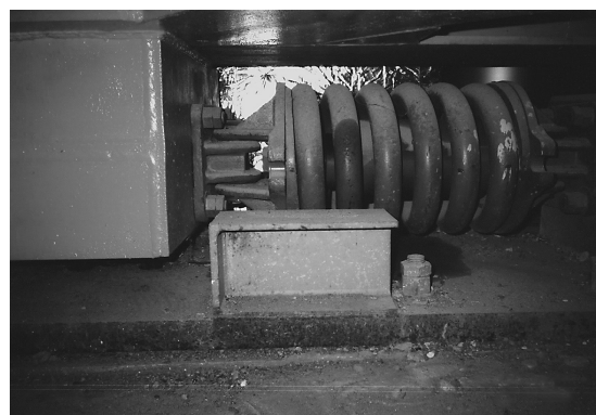
写真3 コイルバネとオイルダンパー
