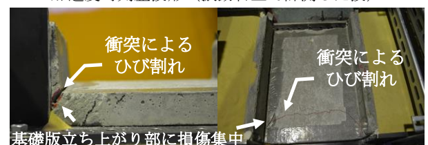
図 9 衝突によるモルタル擁壁のひび割れ
