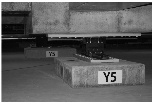
総合研究棟（農学系） 免震層
