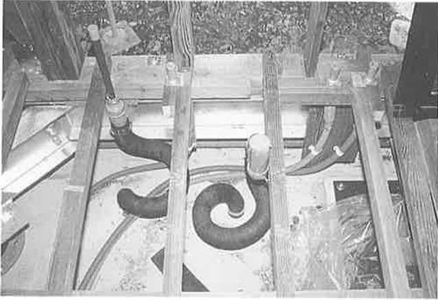
f) 排水設備
