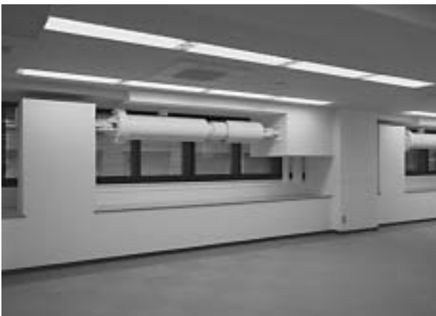
写真3 減衰こま設置状況
